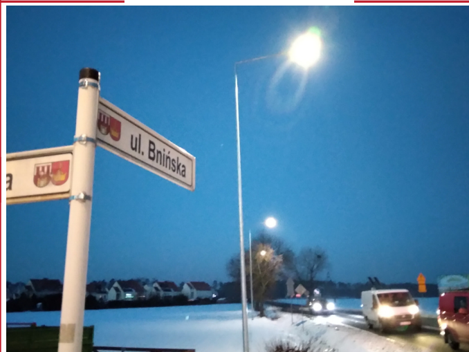
Oświetlenie ul. Bnińskiej
